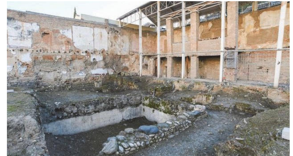
Estado en el que se encontraba el Maristán cuando en febrero de 2020 comenzaron los trabajos de restauración.
